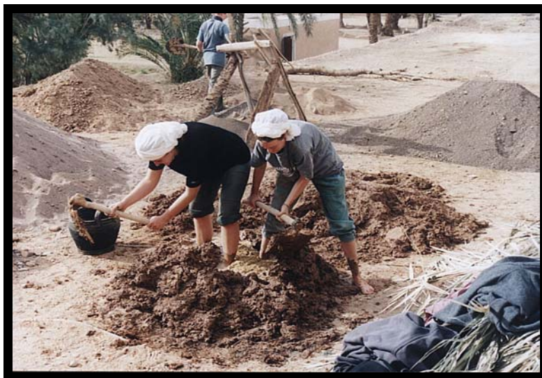
Ulrike Bogutzki und Eva Maria Kagermann-Otte beim Anmischen von Erde, Sand und Stroh für den Putzmörtel. Es wurde dabei harte Beinarbeit gefordert, nach dem Motto „Immer eine handbreit Lehm unter den Füßen“.
